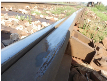
Obr. 5: Dilatačný (voľný) spoj na koľajnici neďaleko železného mostu
