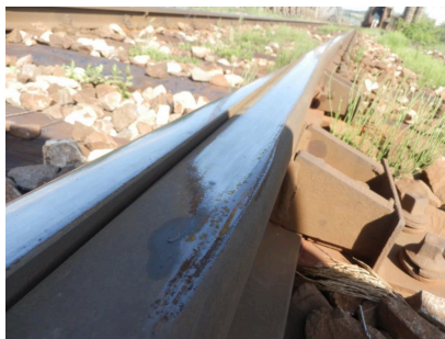
Obr. 1: Dilatačný (voľný) spoj na koľajnici neďaleko železného mostu.
